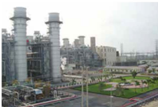
Hình 2.9. Nhà máy nhiệt điện Phú Mỹ
